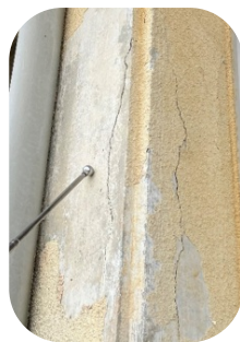
柱の縦方向のひび割れ
