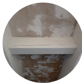
梁の横方向のひび割れ
