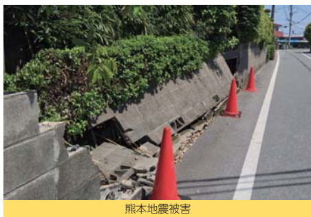
熊本地震被害
