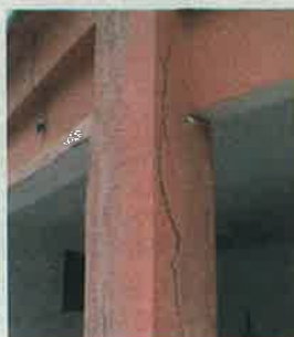
主筋に沿ってひび割れが起きているRC造の柱
