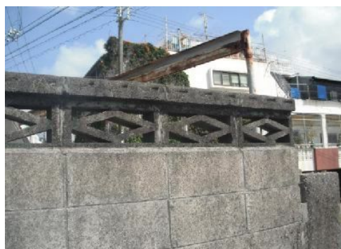
透かしブロックが横に連続している 目地が狭く、無筋になり危ない
