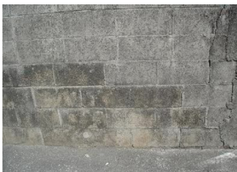
重ね積みあり、下は擁壁 目地が乱で鉄筋が入らない
